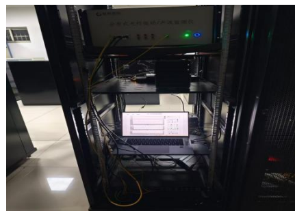
瑶北机房设备调试
