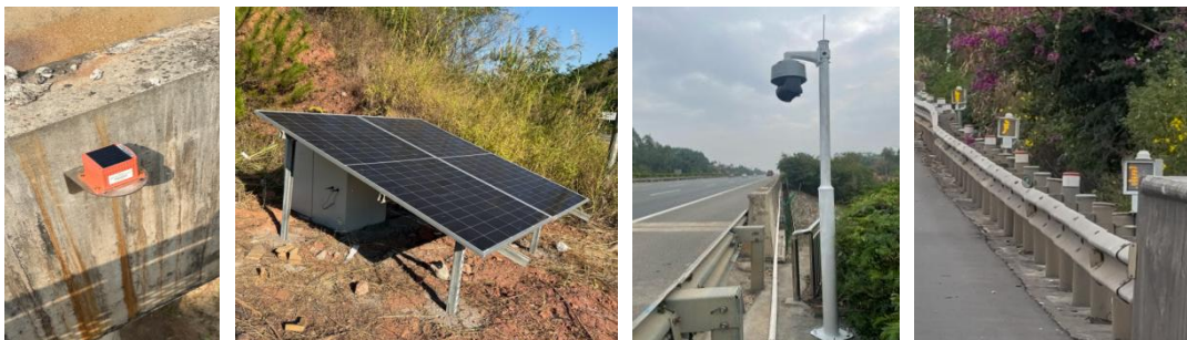
图3 桥梁轻量化损毁监测系统设备安装现场
