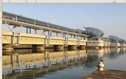
水工建筑物监测
