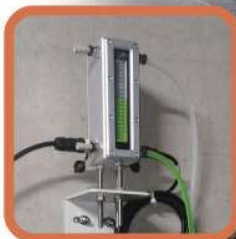
隧道 自动化监测
