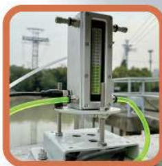
泵闸 自动化监测
