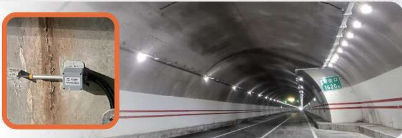
隧道 自动化监测
