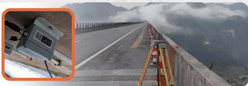
桥梁 自动化监测
