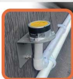
综合管廊 自动化监测
