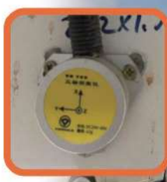
桥梁 自动化监测
