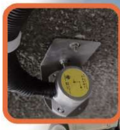
桥梁 自动化监测
